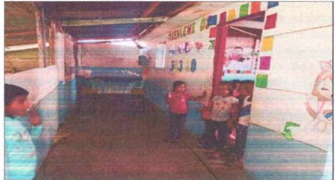
Foto 4: ampliacion de dos aulas ya que solo cuenta con dos hiladas de bolck
