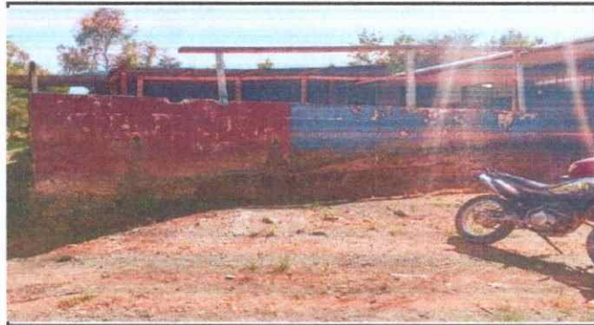
Foto 3: Vista frontal del establecimiento que es necesario la sustitución de galeras por la seguridad integral de los estudiantes
