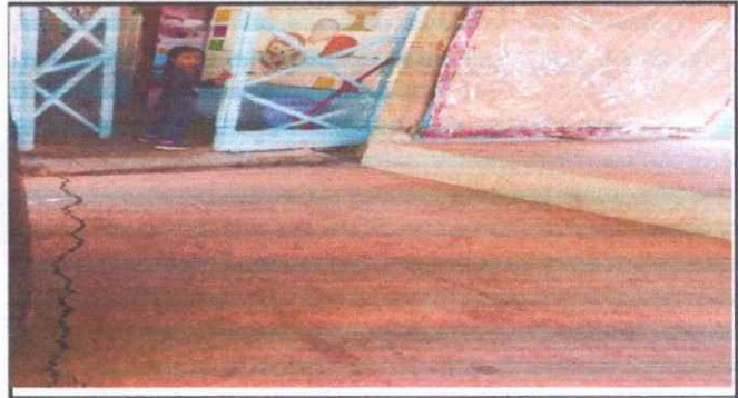
Foto 2: Se puede observar la necesidad de sustitucion de piso concreto en mal estado
