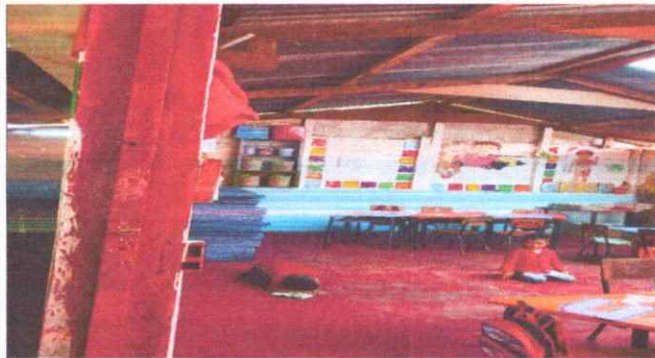
Foto 3 Observandose que hay mucha necesidad nuestra escuela. Sustitucion de reglas, por costaneras ya esta muy deterioradas.
